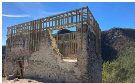
Fig. 5. Vista noroeste del bastión SO del castillo de Viñaza después de la intervención
